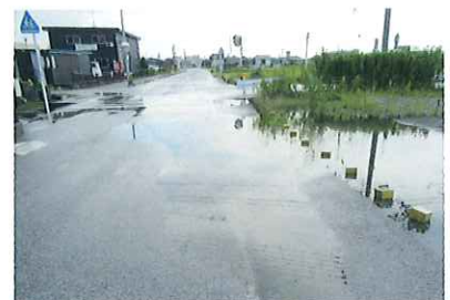
3年前の小堀南田附町交差点付近。陥没がひどく、雨で大水溜まり
